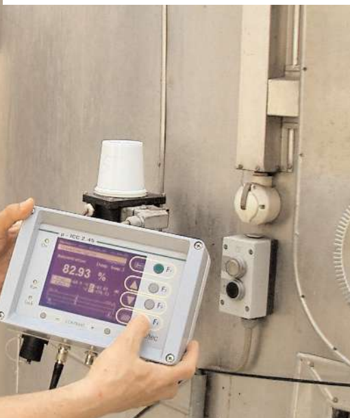
pro/M/tec-Techniker bei der Inbetriebnahme von Messgeräten im Einsatz. Kleines Foto: Visualisierung und Einbindung der Messgeräte in der Prozesssteuerung.
